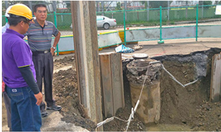
多次會勘中林路塌陷問題的李順進議員（橫條紋衣者），盼市府建立破壞道路者的付費機制。（圖片來源：李順進議員服務處提供）
