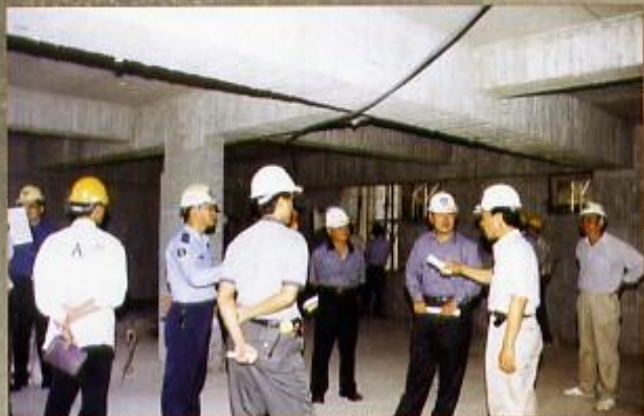
專案小組現場會勘施工不良部份，並聽取建築結構技師說明
