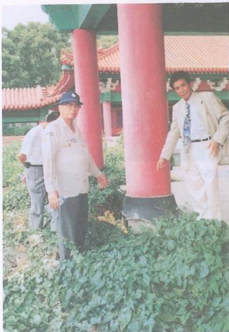
● 旗山孔廟西廡廂房樑柱地基土壤嚴重流失。
