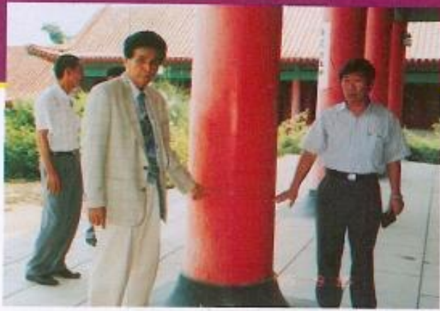
● 副議長黃振塊勘察旗山孔廟主體建築樑柱，發現有明顯裂痕。
