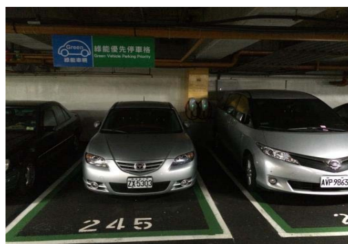
圖 22 場內電動車充電柱
