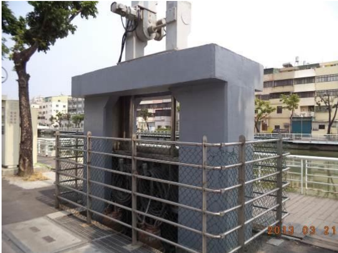
(圖二) 前鎮鎮東三街雨水箱涵排入前鎮河之閘泵
