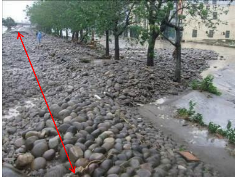
照片 6 旗山溪堤防損壞段 (2009/08)
