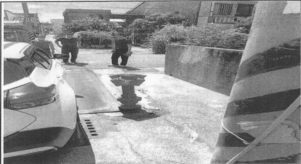
說明：力行路 5-5 消防栓位置圖 1
